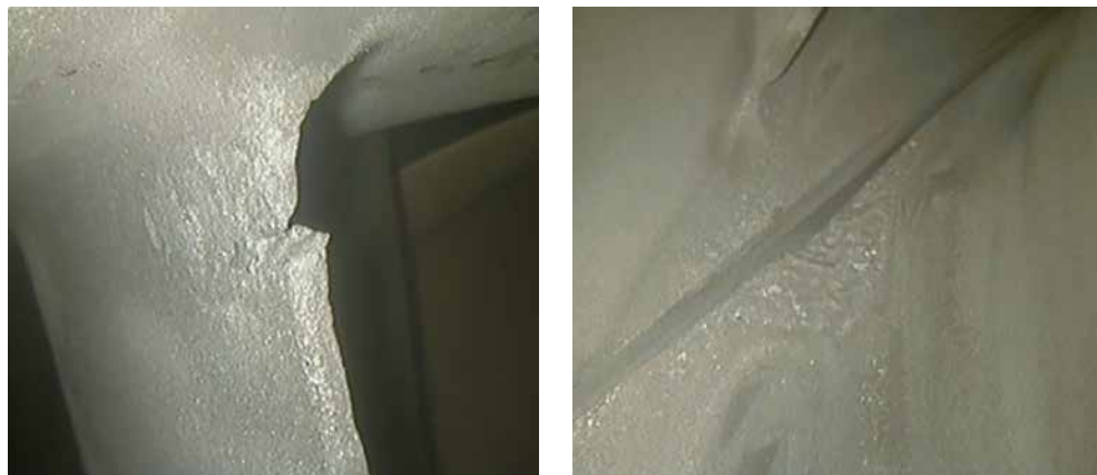
Рисунок 5.23. Эрозионный износ и прогар с трещиной выходной кромки аппарата первой ступени ТВД (ТО-8000)
