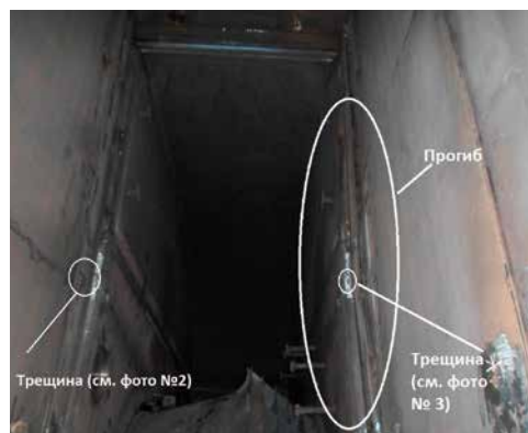
Рисунок 5.45. Дефекты в верхней части выхлопного патрубка
