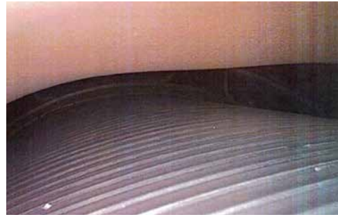
Рисунок 5.18. Деформация экрана жаровой трубы
