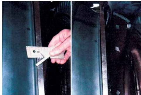
Рисунок 5.38. Провисание переходного патрубка (наработка 24 323 часа)
