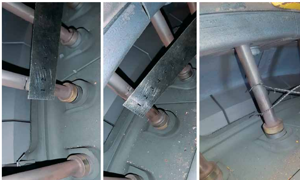
Рисунок 5.43. Повреждения («пропилы») трубок охлаждающего воздуха
