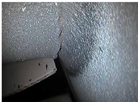
Рисунок 5.25. Эрозионный износ входной кромки соплового аппарата второй ступени ТВД (наработка 4032 часа)
