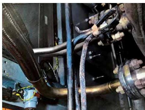
Рисунок 5.54. Обгоревшая изоляция кабеля электрообогрева (наработка 8915 часов)
