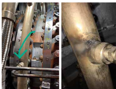
Рисунок 5.55. Прогары импульсных трубок при коротком замыкании
