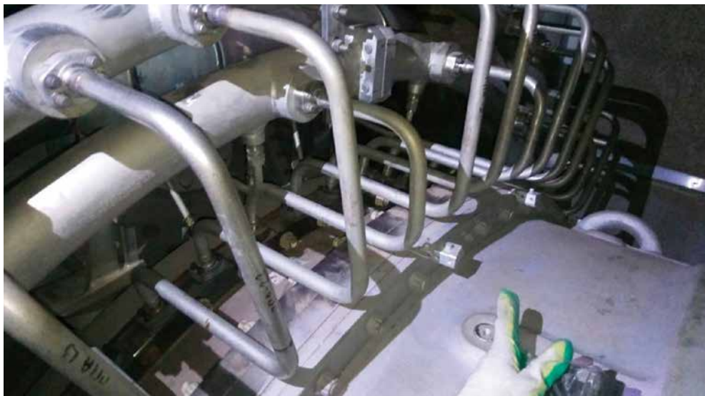
Рисунок 5.42. Трубки подачи охлаждающего воздуха от коллекторов в силовую турбину
