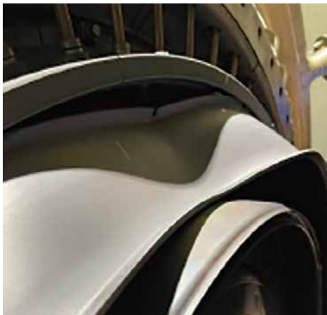
Рисунок 5.35. Деформация наружной секции переходного патрубка ТНД (наработка 28 888 часов)
